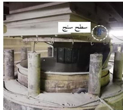
شکل ۴- سطح سنج نصب شده در بالای محفظه سنگ‌شکنی.
